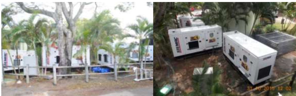
Figura 118: Instalação de geradores para fornecimento de energia de som e luz de palco no evento Festeja
