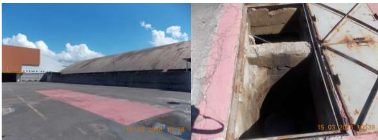
Figura 130: Reservatório de armazenamento de água pluvial - 60.000litros
