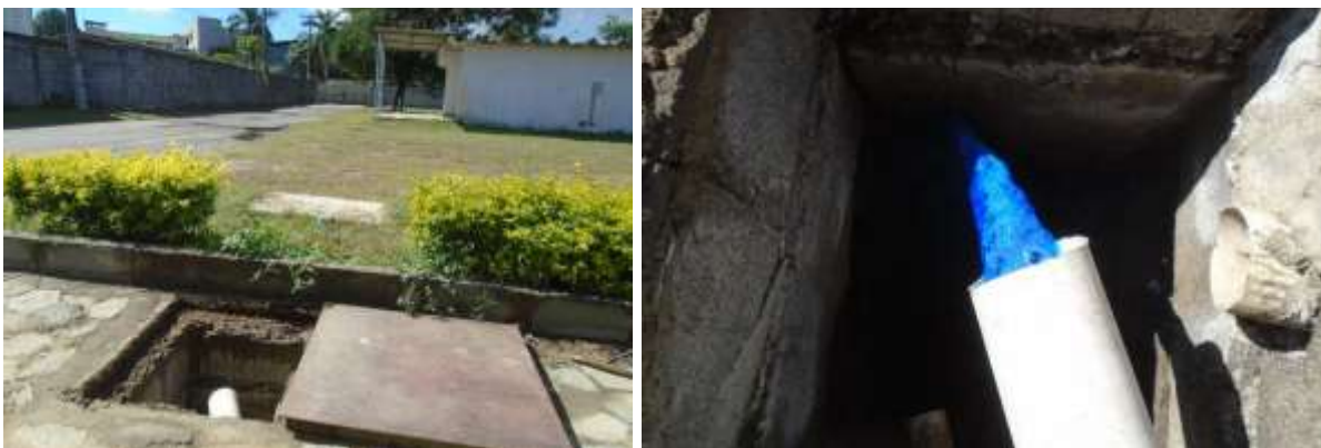
Figura 122: Interligação Cenário Hall à rede interna de coleta - caixa de passagem/ teste de corante
