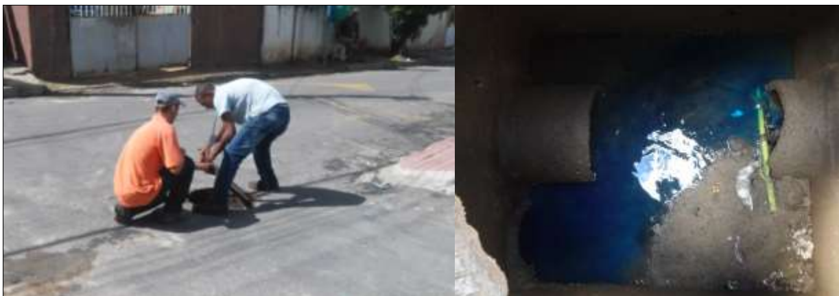
Figura 125: Lançamento de efluente, após tratamento, em rede pública de drenagem – Rua Boa Vista
